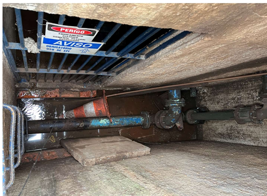
Booster Igreja – Fonte: Visita Técnica
