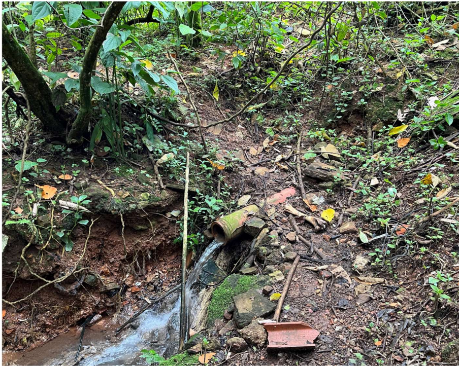
Lançamento de Esgoto – Fonte: Visita Técnica
