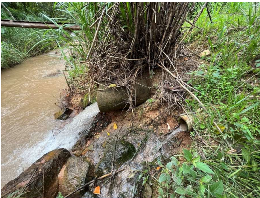
Lançamento de Esgoto – Fonte: Visita Técnica
