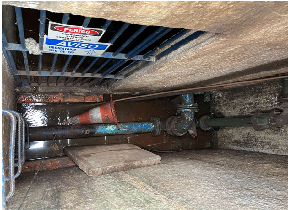
Booster Igreja – Fonte: Visita Técnica
