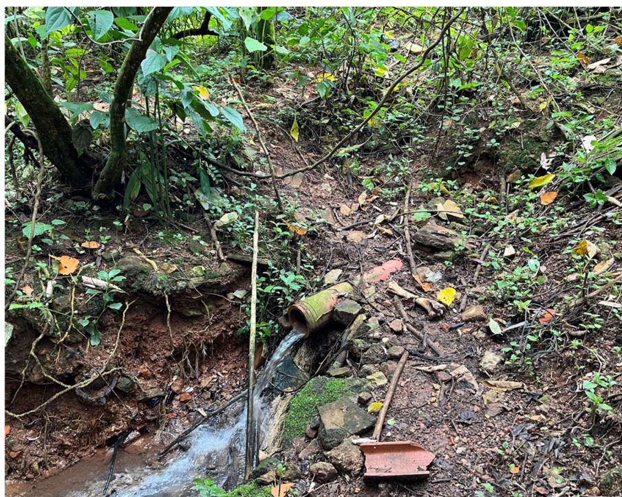
Lançamento de Esgoto – Fonte: Visita Técnica
