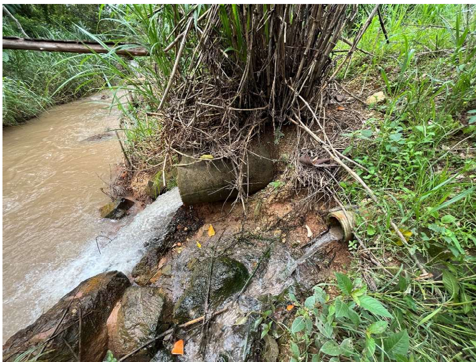
Lançamento de Esgoto – Fonte: Visita Técnica
