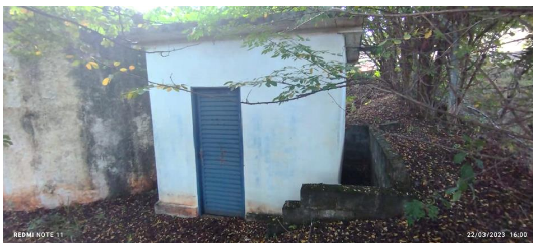
Figura 121 – EAT03 Área externa da elevatória
