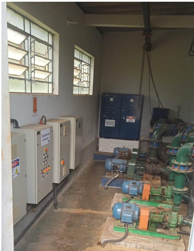
Figura 93 – Painéis e conjuntos motobomba da EAT01 e EAT04
