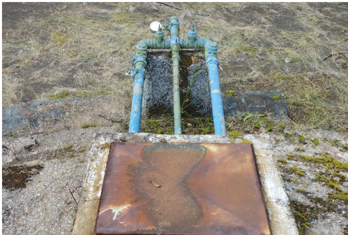
Figura 99 – Conjunto motobomba da EAT 05
