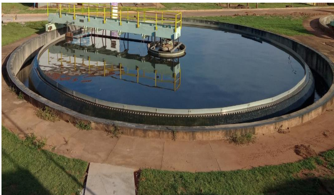
Figura 244 – Decantador secundário em funcionamento
