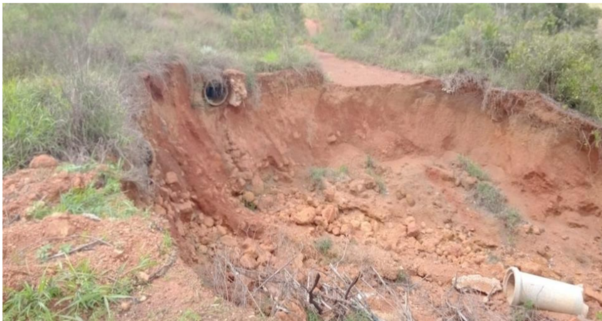
Figura 49 – Trecho da adutora de água bruta danificado em decorrência de erosão
