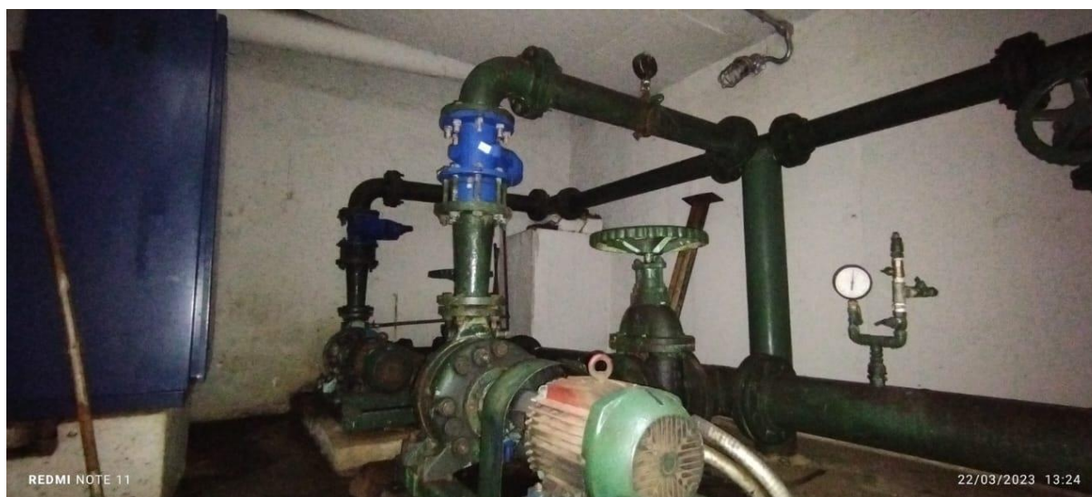
Figura 101 – Conjunto motobomba do Booster 01
