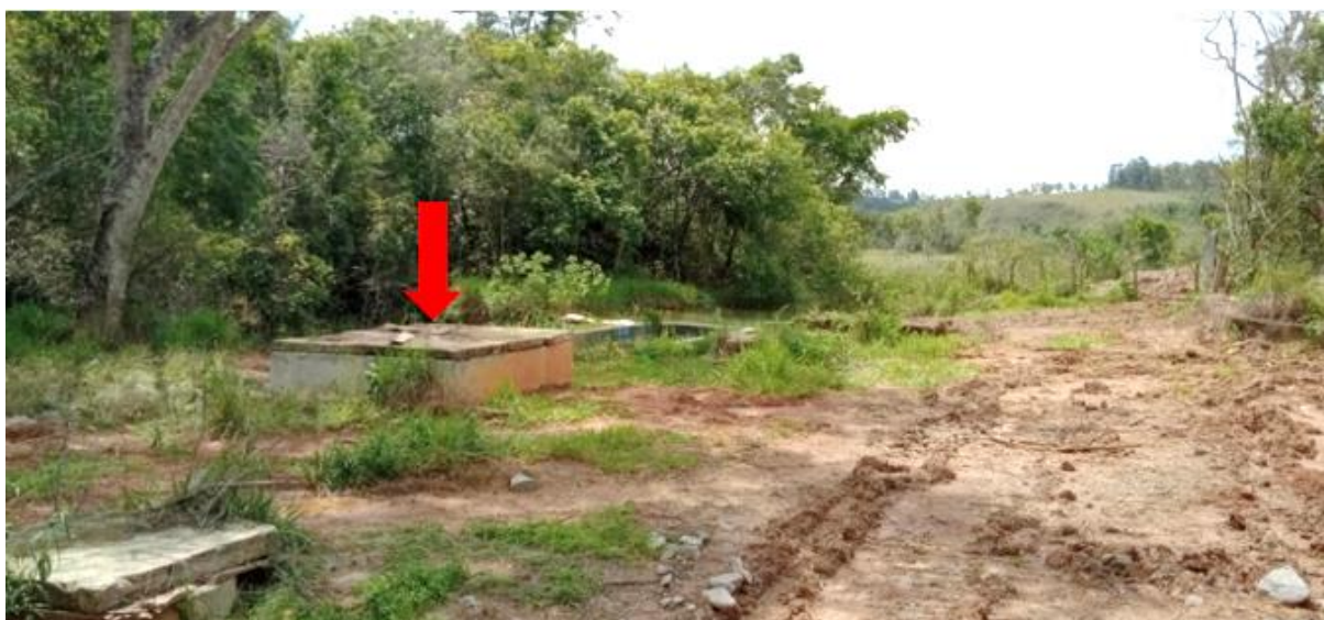
Figura 30 – Acesso a barragem e caixa de macromedição indicada pela seta
