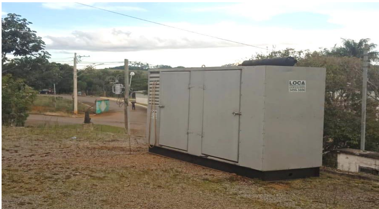
Figura 83 – Gerador de energia
