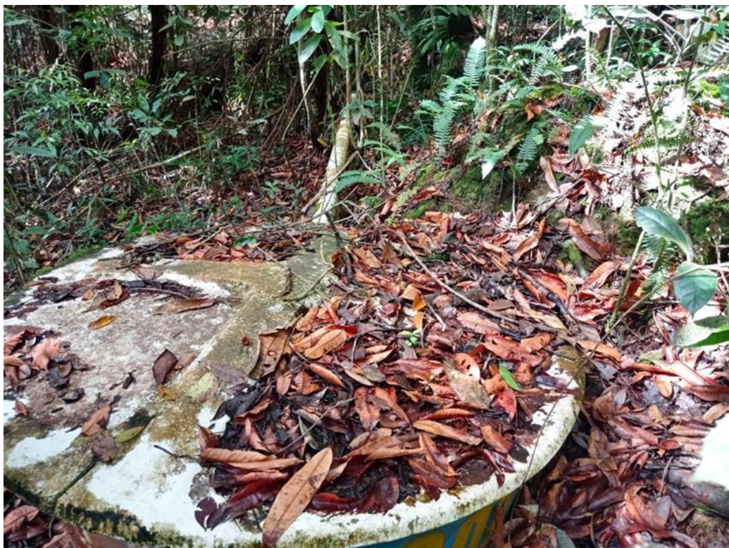
Figura 41 – Tubulação e caixa em fibra com volume de 500 litros
