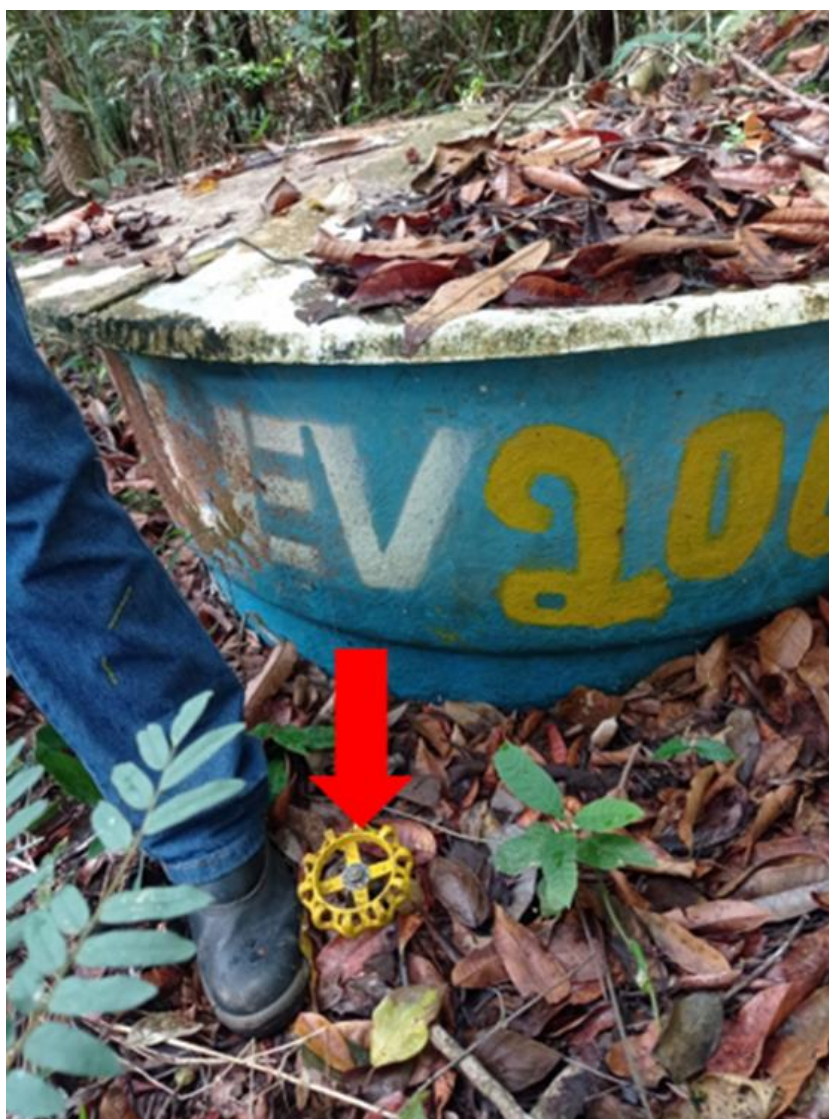
Figura 43 – Registro na saída da tubulação de água bruta
