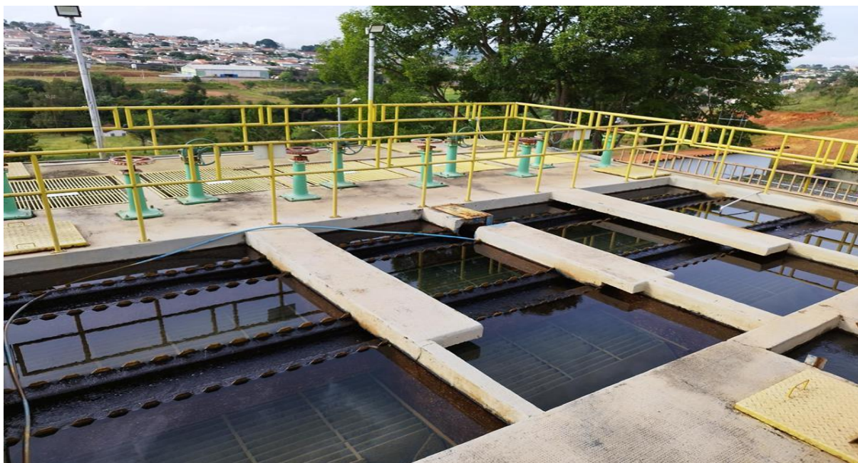
Figura 70 – Vista dos Decantadores
