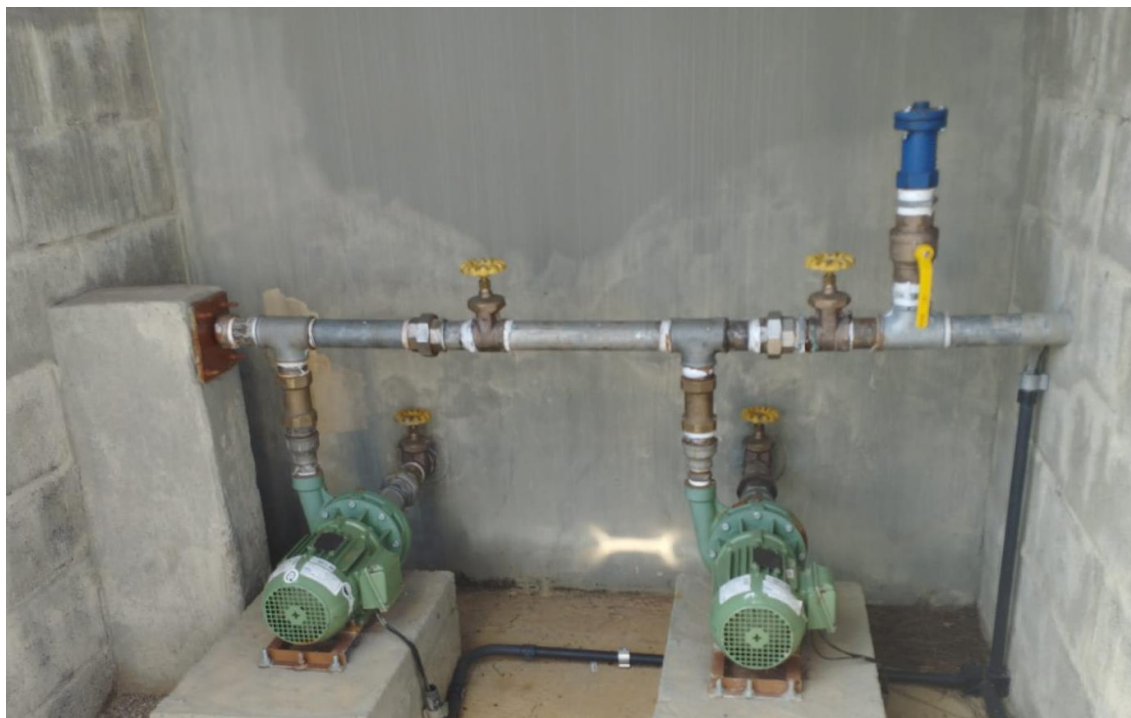
Figura 100 – Conjunto motobomba da EAT 06
