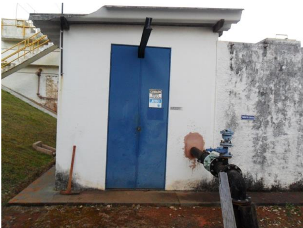
Figura 122 – Necessidade de pintura da EAT01/04
