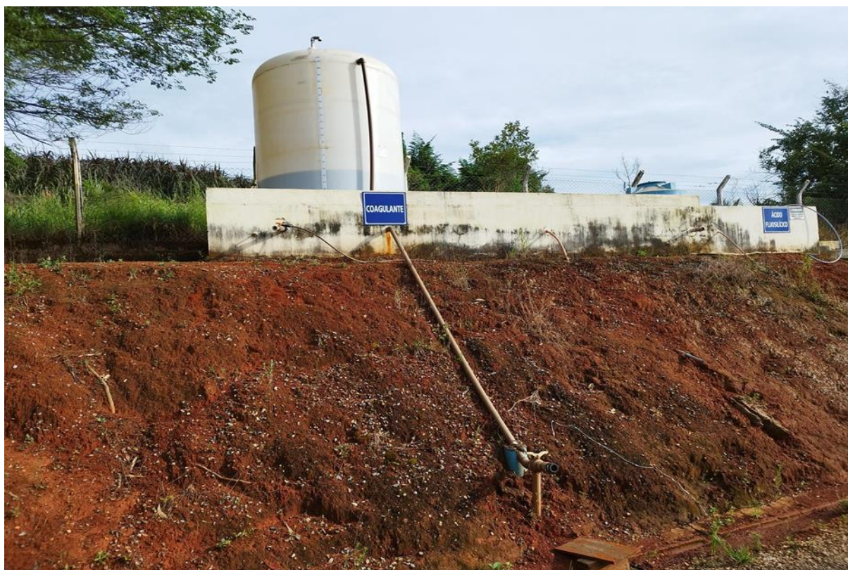
Figura 78 – Reservatório de contenção em caso de vazamento de produto químico
