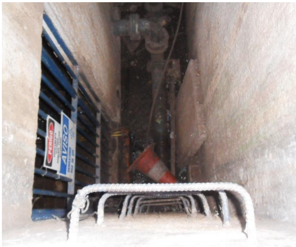
Figura 127 – Acesso ao Booster 01
