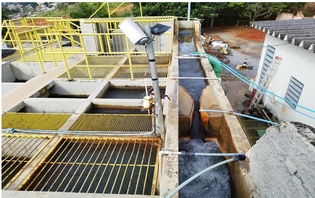
Figura 117 – Vista da Calha Parshall
