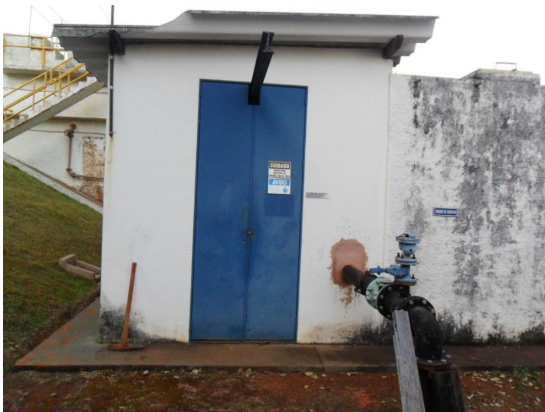
Figura 119 – Necessidade de pintura da EAT01/04
