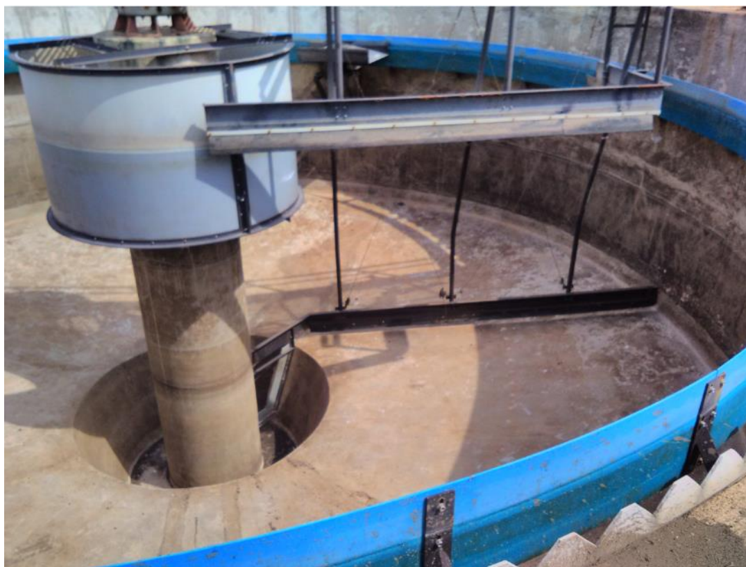
Figura 246 – Foto da parte interna de Decantador Secundário vazio
