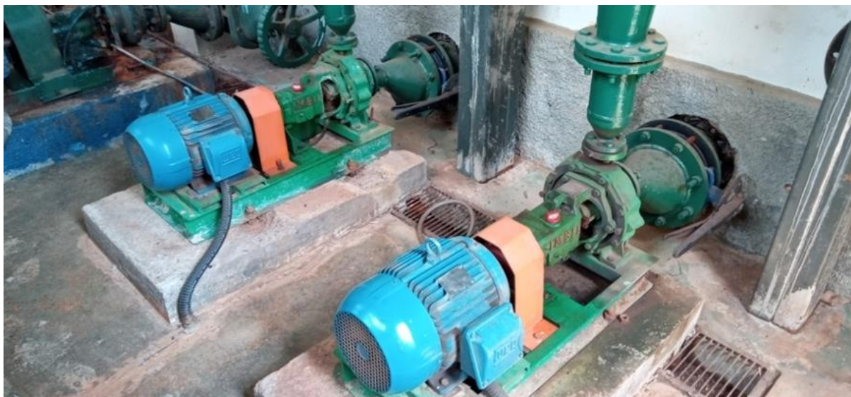
Figura 96 – Conjunto motobomba da EAT 04
