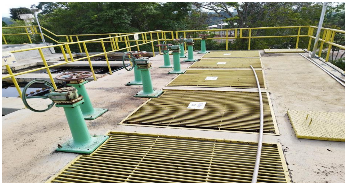
Figura 72 – Vista dos filtros
