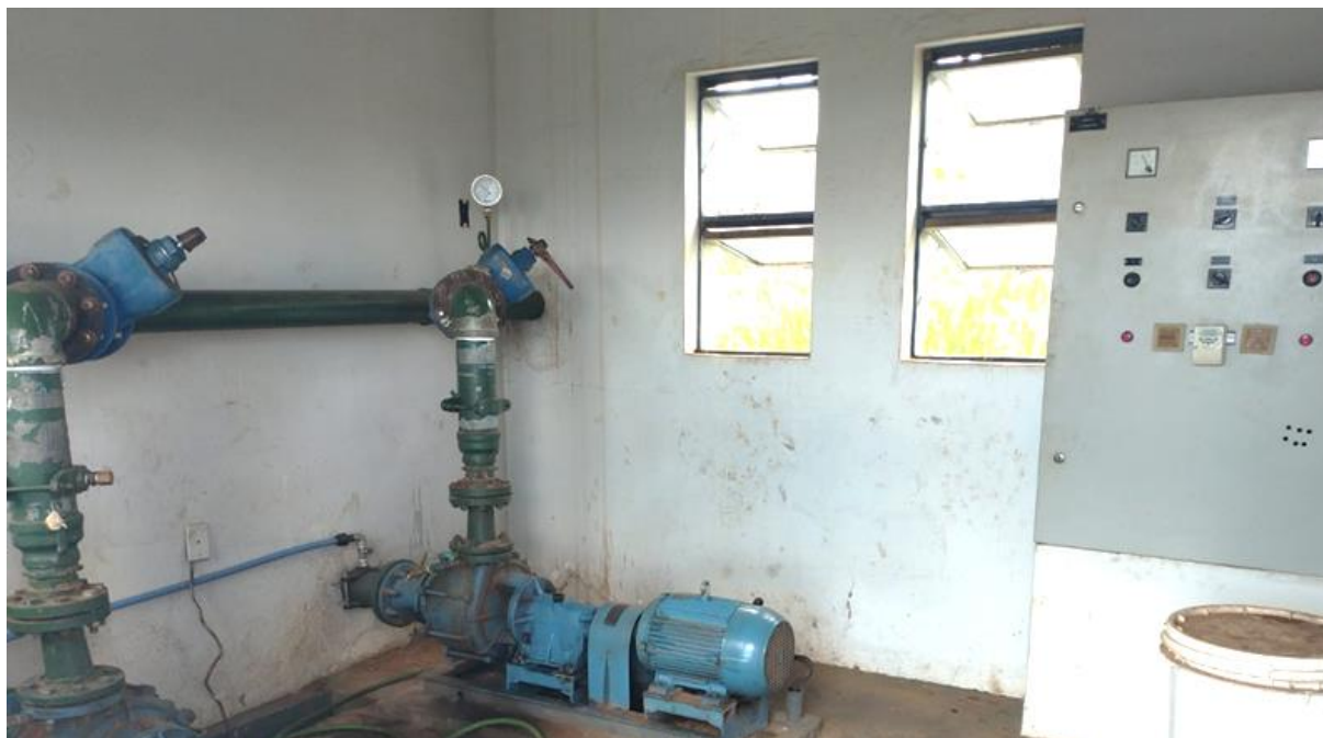
Figura 94 – Painel e conjuntos motobomba da EAT 02
