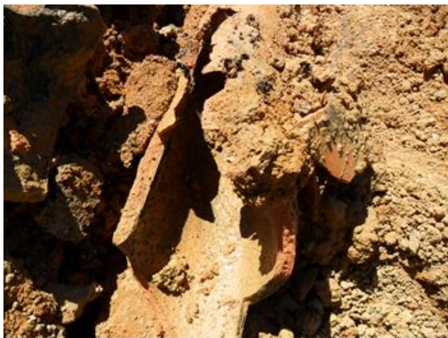
Figura 197 – Trecho de rede coletora de esgoto danificado
