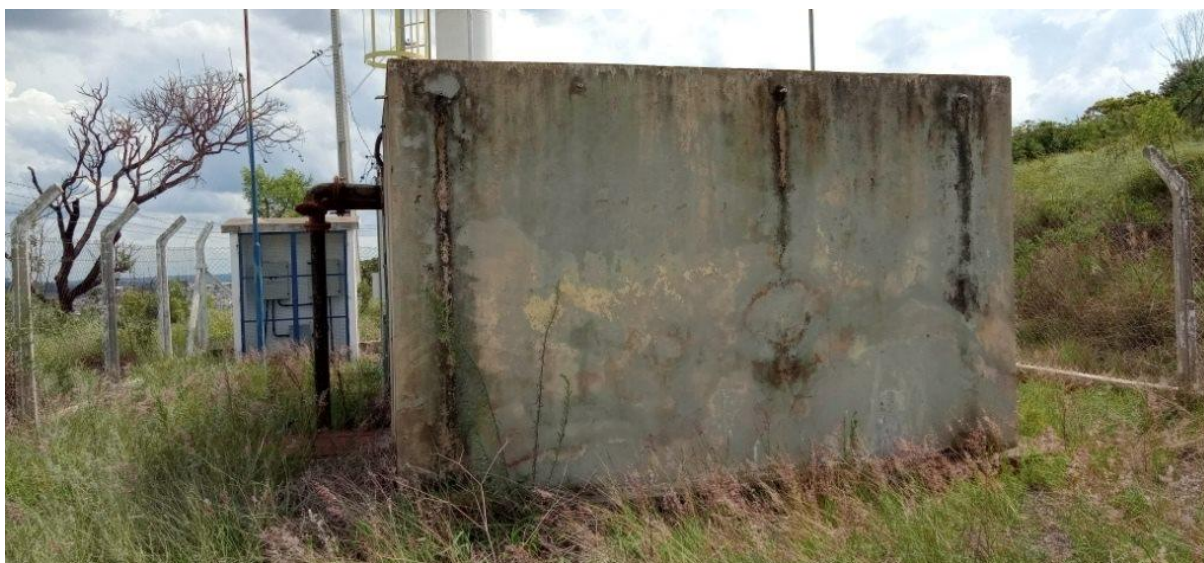
Figura 161 – Vista da área interna do RAP06 e REL07
