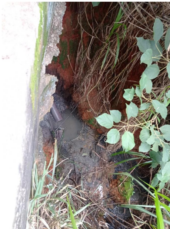
Figura 196 – Lançamento de esgoto in natura no solo
