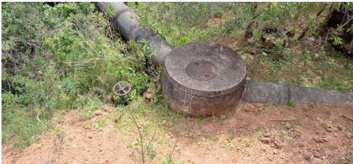
Figura 33 – PV na AAB proveniente da Captação Superficial do Córrego Engenho da Serra
