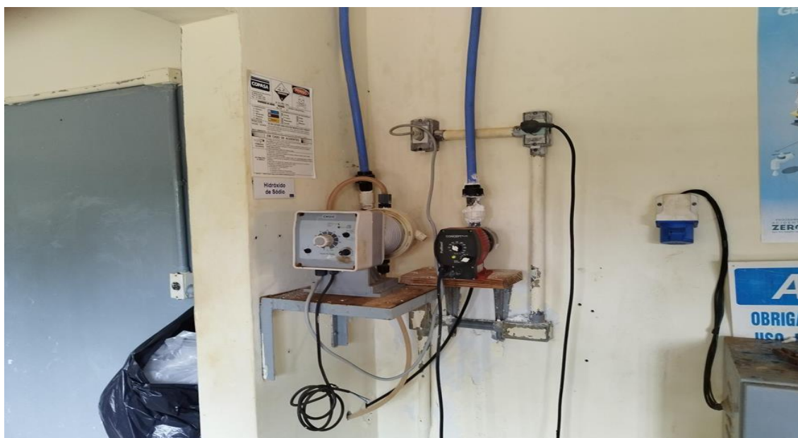
Figura 77 – Sala de dosagens
