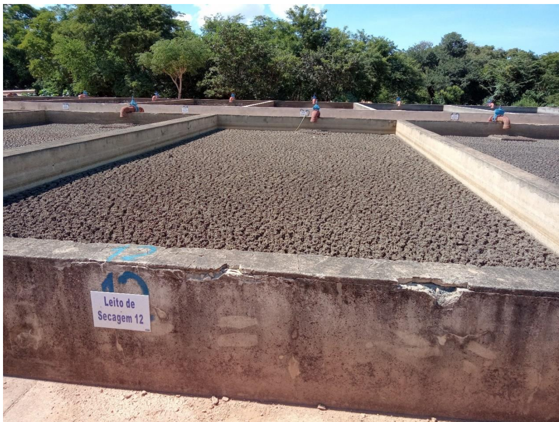
Figura 248 – Leito de secagem similar em operação
