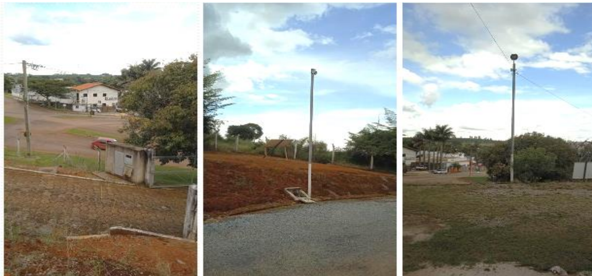
Figura 82 – Padrão de energia elétrica (CEMIG) e postes de iluminação distribuídos no pátio da ETA
