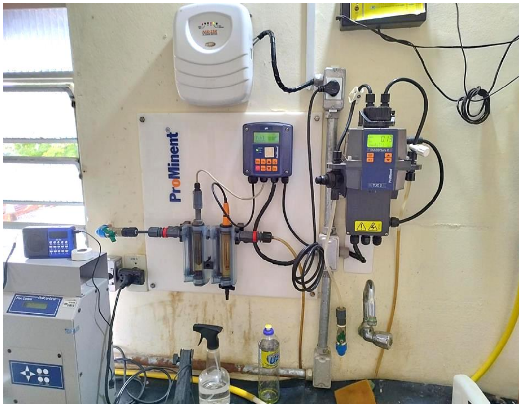
Figura 80 – Equipamentos de processo
