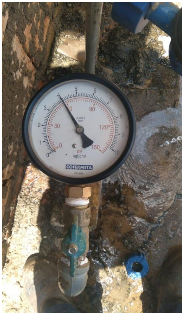
Figura 170 – Acompanhamento de pressões nos cavaletes
