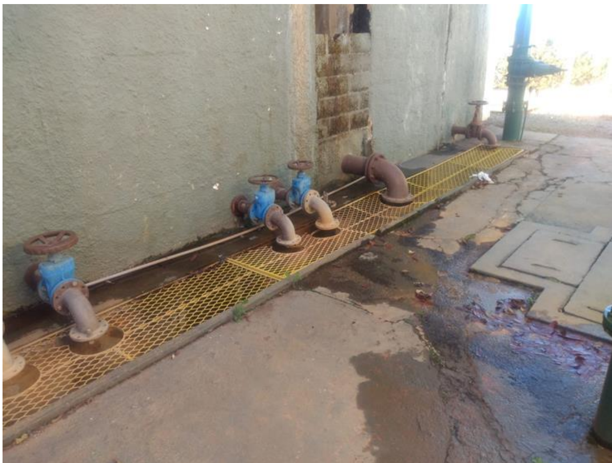
Figura 110 – Evidência de vazamento
