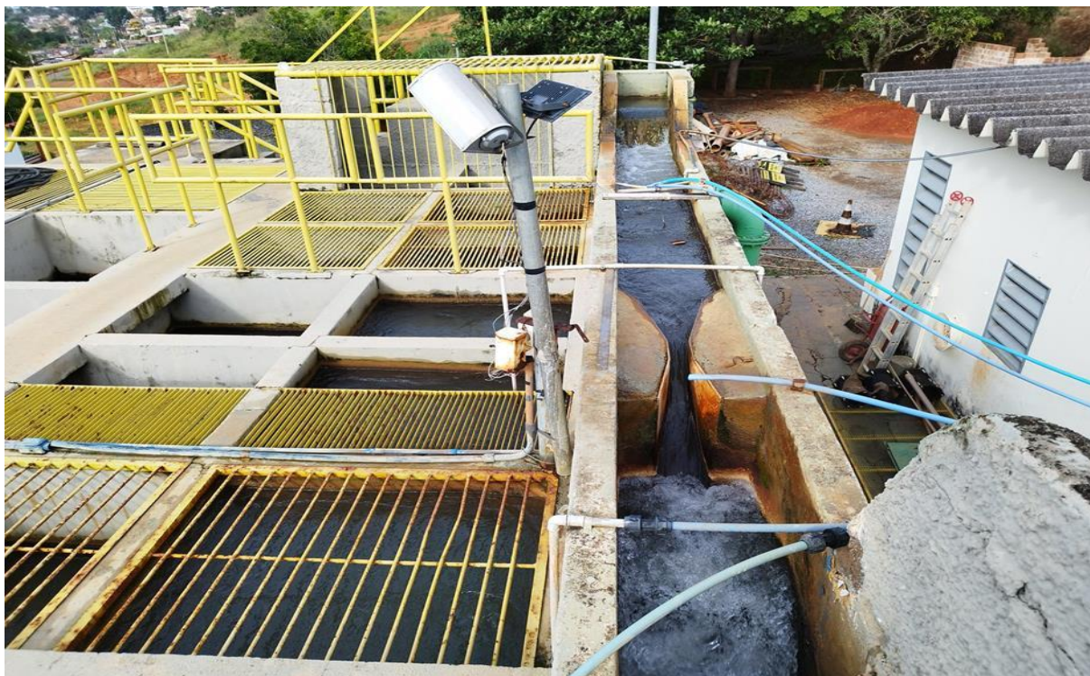
Figura 67 – Vista da Calha Parshall com os pontos de aplicação dos produtos químicos
