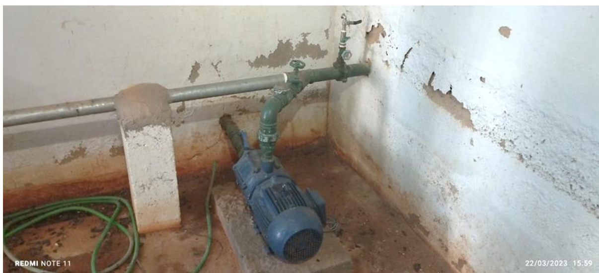
Figura 95 – Conjunto motobomba da EAT 03
