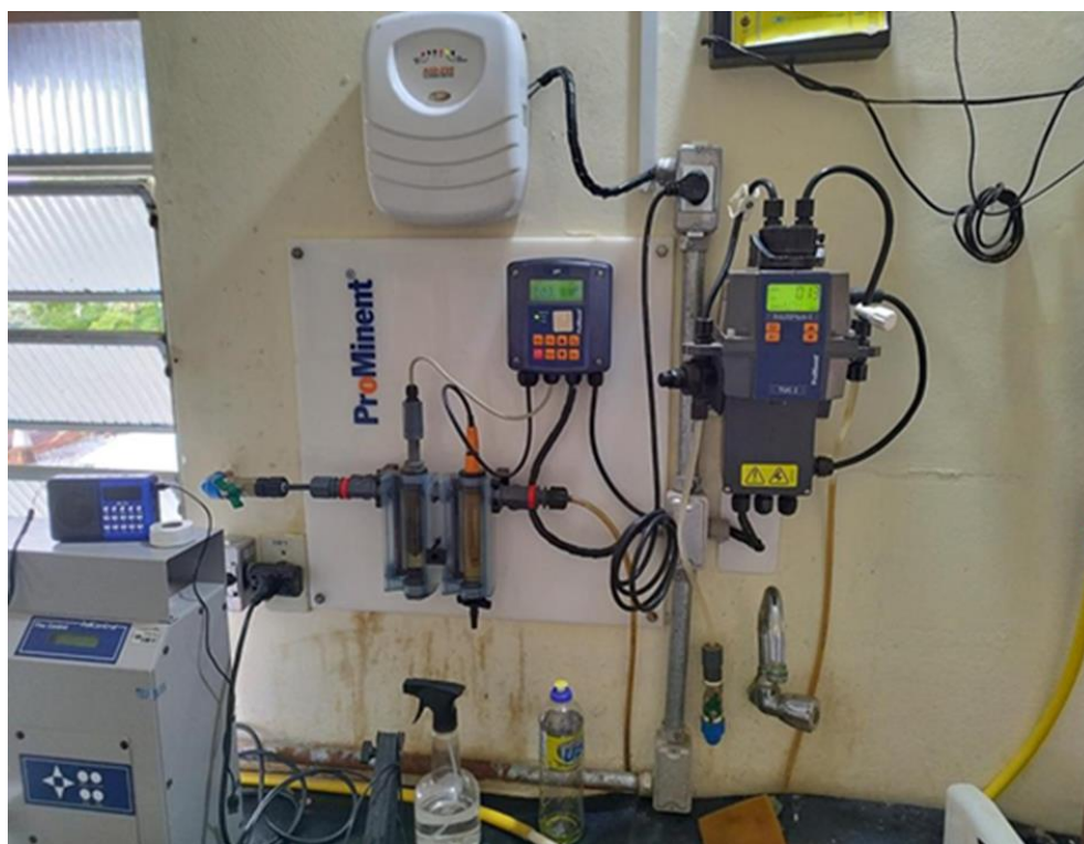
Figura 112 – Equipamentos de processo
