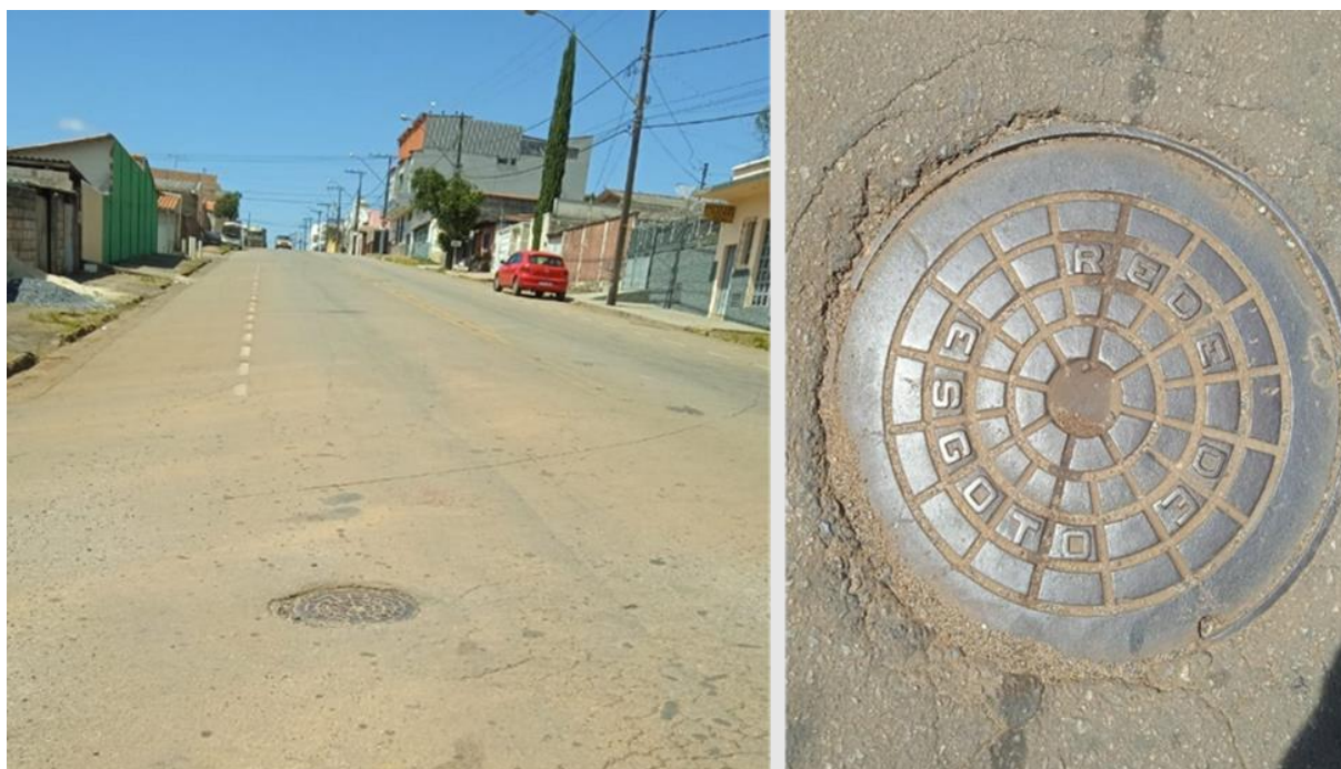
Figura 192 – Poço de Visita de esgoto instalado nas redes coletoras de esgoto
