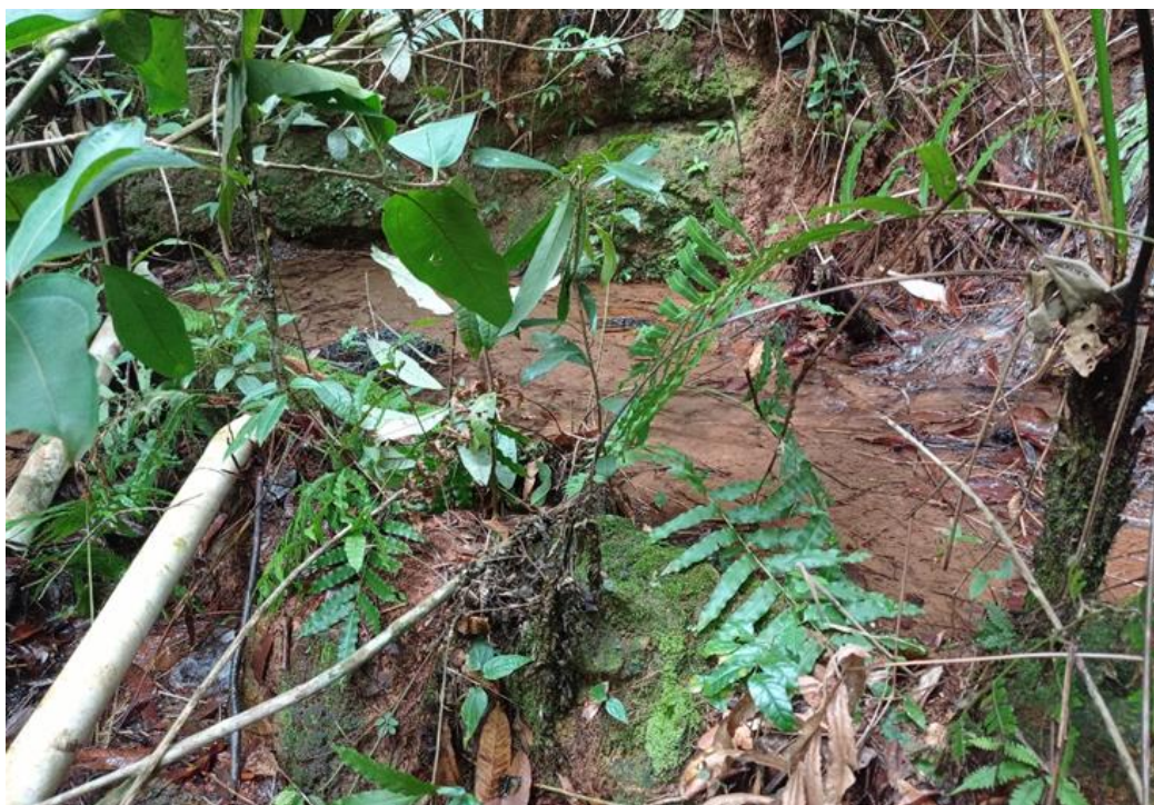
Figura 42 – Tubulação de tomada de água da captação
