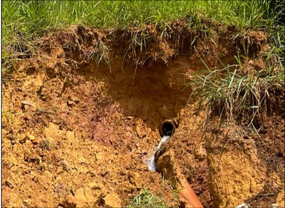
Lançamento de esgoto in natura – Campos Altos
