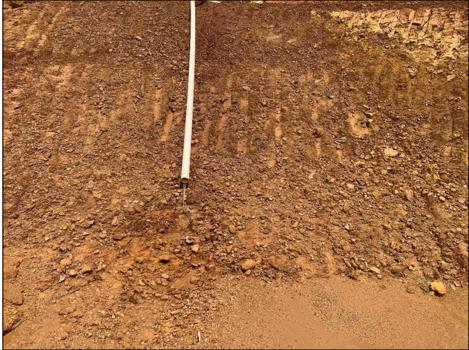
Lançamento de esgoto in natura – Campos Altos
