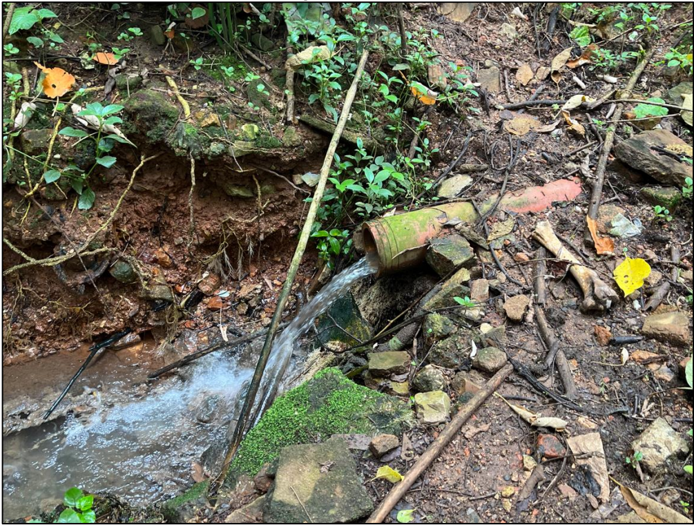
Lançamento de esgoto in natura – Campos Altos
